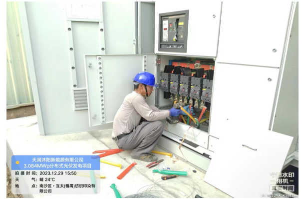
箱变低压室接线
