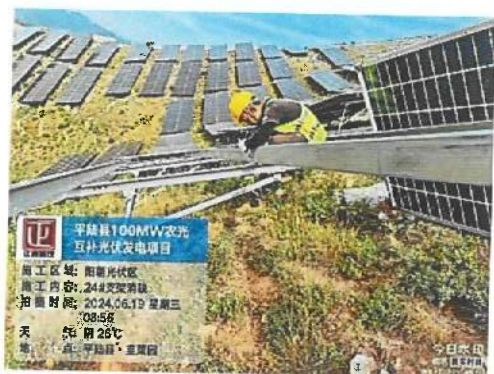
阳朝区域 24#地块支架消缺
