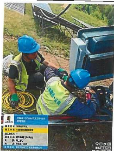
东郑区域 15#地块逆变器接地
