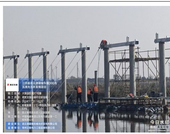
柔性支架边锚连接
