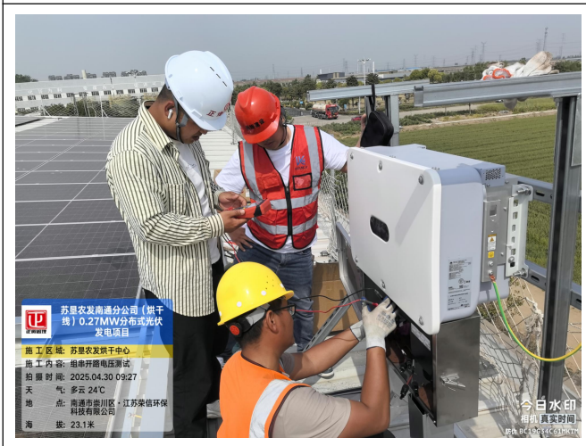
组串开路电压测试
