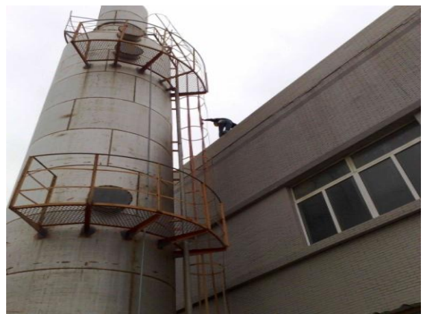
登高作业没有防护措施
