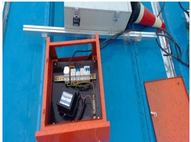
施工作业，配电箱安全等级不够
