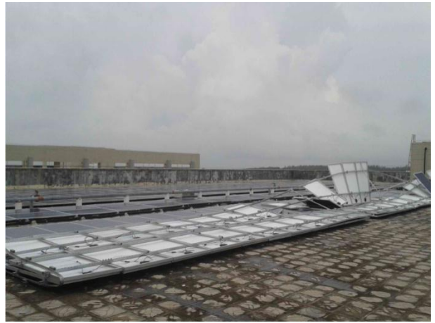
配重不到位 方阵被吹翻不合
