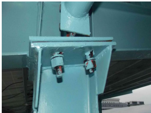
支架螺丝锈蚀、未紧固到位，支撑强度不够
