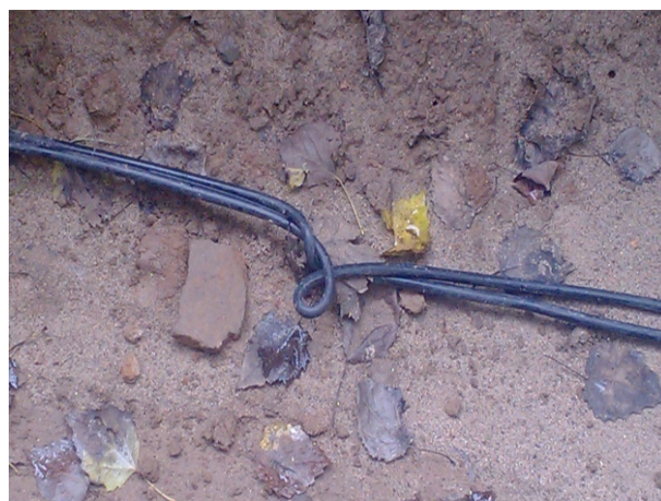
线缆打结，直埋时容易造成破损
