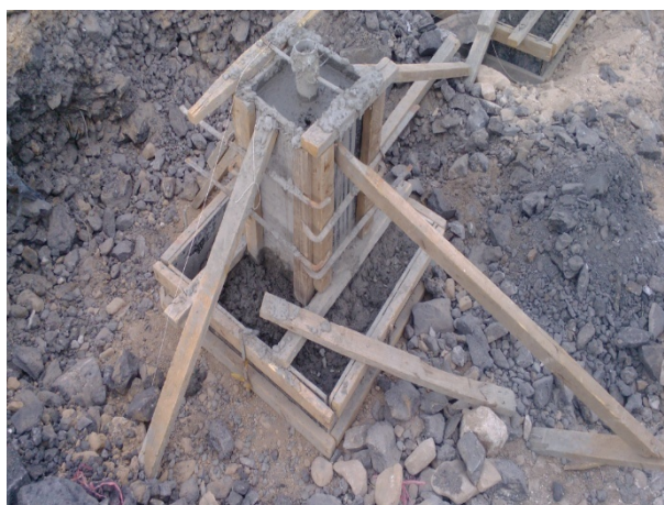
基础浇筑缺乏振动
