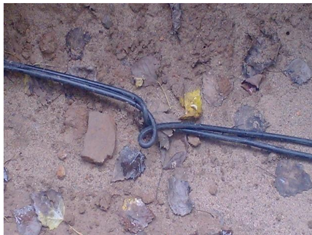
线缆打结，直埋时容易造成破损
