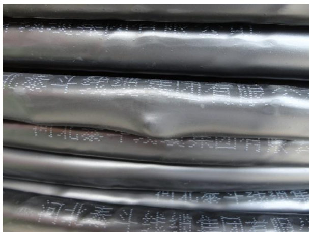
高压线缆材料中出现接头
