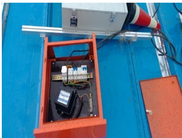
施工作业，配电箱安全等级不够
