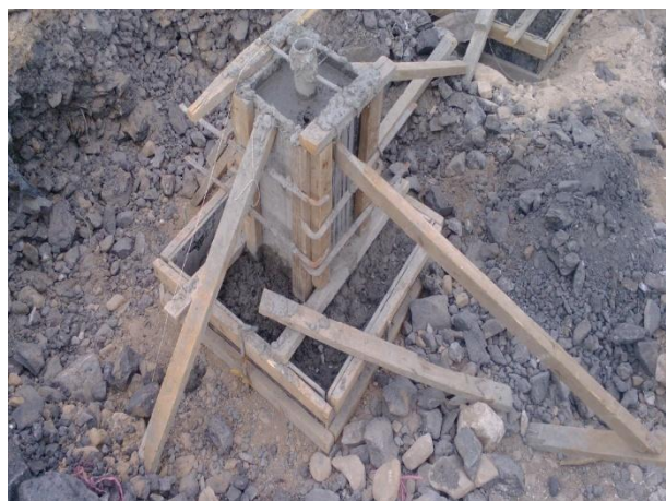
基础浇筑缺乏振动
