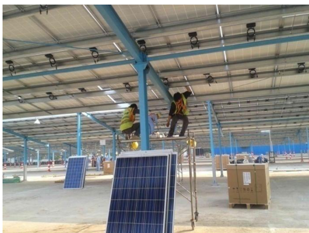
施工现场未佩戴安全帽
