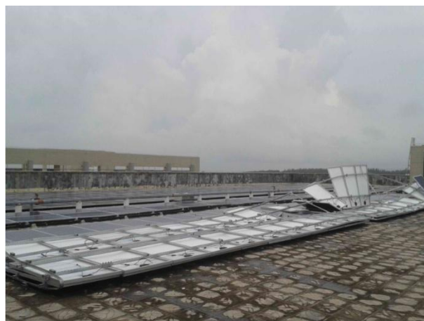
配重不到位 方阵被吹翻不合
