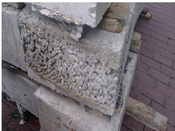
混凝土施工质量不合格，
