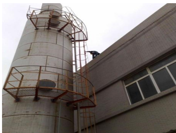
登高作业没有防护措施
