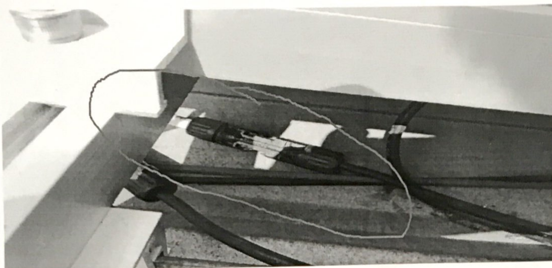
七、组件下的连接线公母头没有绑扎（全部）
