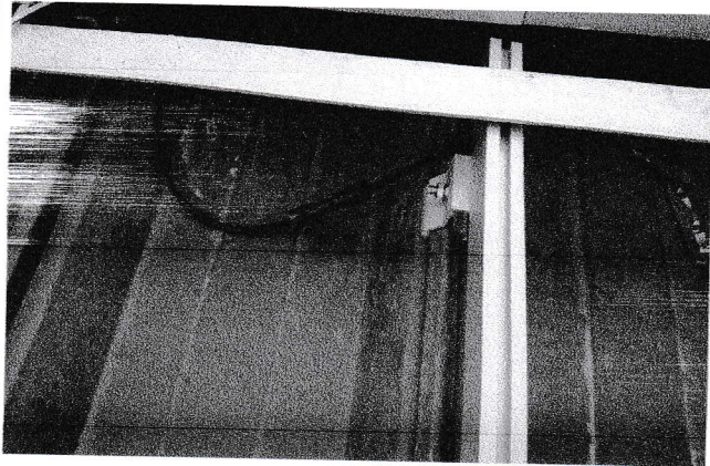
12、接地扁铁焊缝防腐不到位、电缆槽盒接地未接好。
