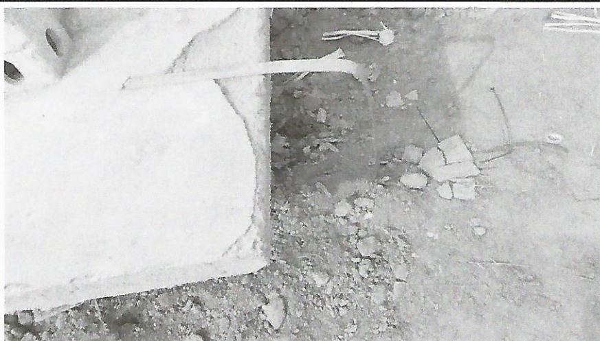
20、走道板交接处固定不牢固。
