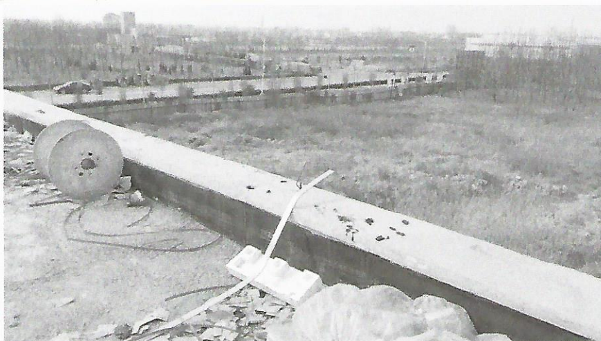
15、10#屋面个别电缆桥架未做变径。
