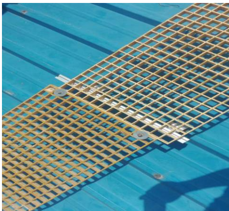
22、屋面部分电缆保护软管保护不到位。
