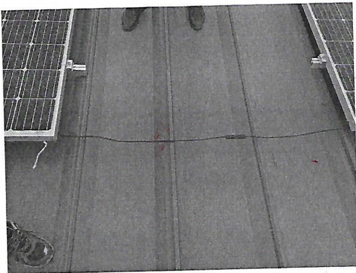
桥架跨接铜网线有脱落情况。
