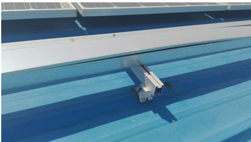
25、屋面组件接地与接地扁钢跨接不牢固；
