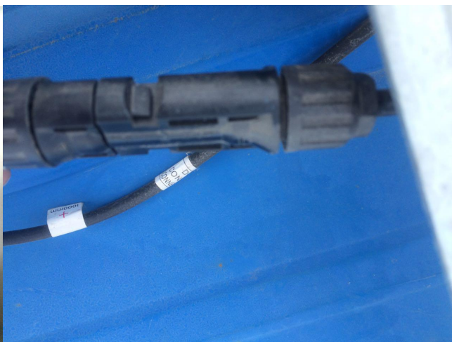
9 屋面部分 MC4 接头紧固放置不到位
