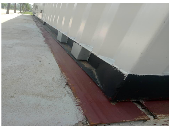
4 设备基础未固定未抹面
