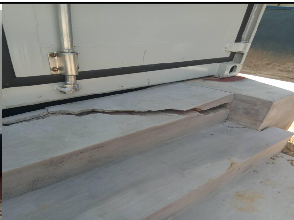
5 SVG 等设备台阶下沉断裂
