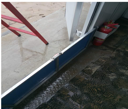
1 一次开关站门渗水
