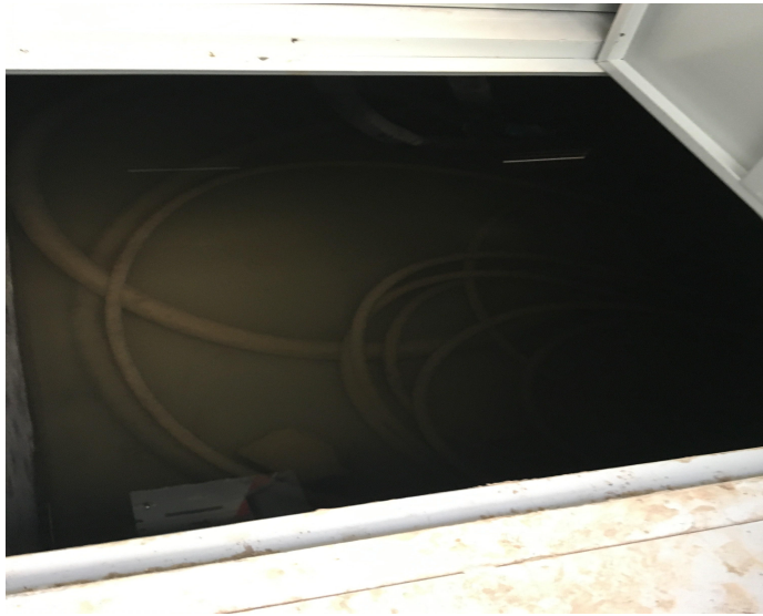
3、平屋面组件均未使用接地孔连接接地线
