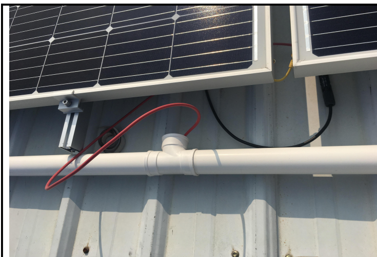
6、现场彩钢瓦损坏严重，存在漏水隐患
