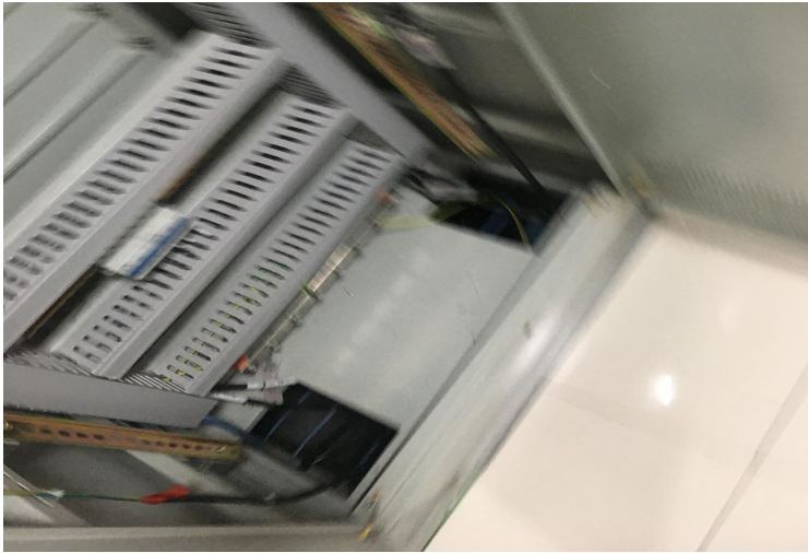
12、二次仓基础与电缆沟连接处防火封堵未做
