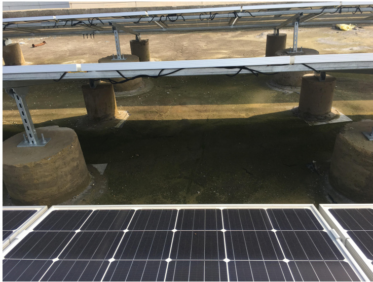
9、立体桥架底部未作封闭，存在安全隐患
