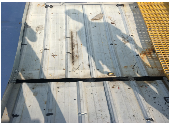
5、部分 MC4 接头散落彩钢瓦屋顶，有进水隐患；部分线缆未吊线
