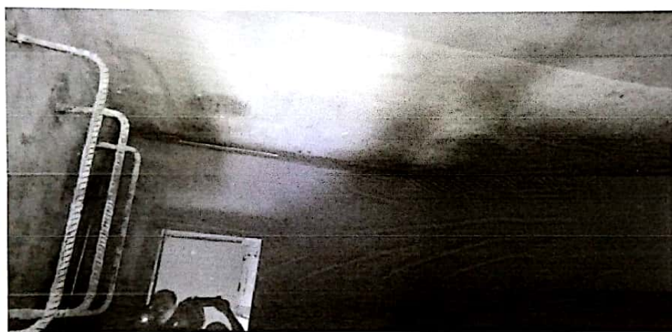
14、、箱变内施工剩余材料未清理。
