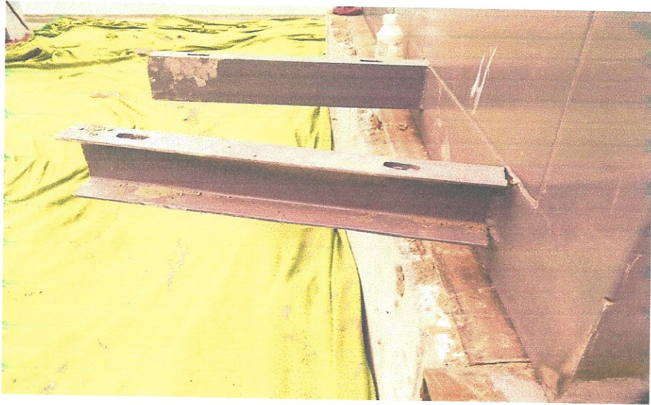
4、室外电缆井规格不符合同规定，且未穿套管
