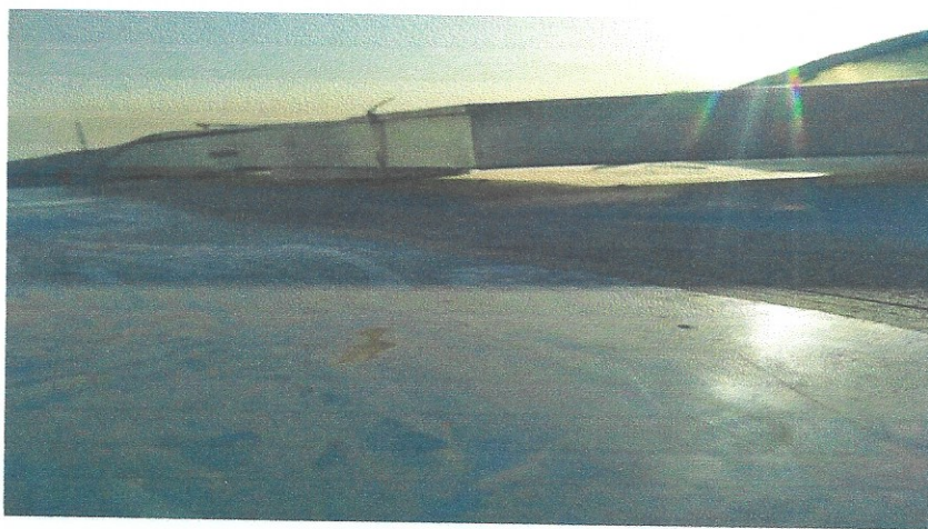
20、69#、70#直流电缆未敷设
