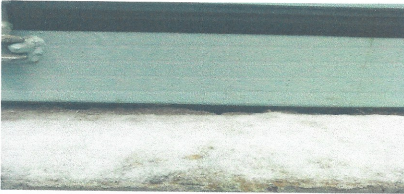
17、设备接地扁铁未涂刷黄绿漆
