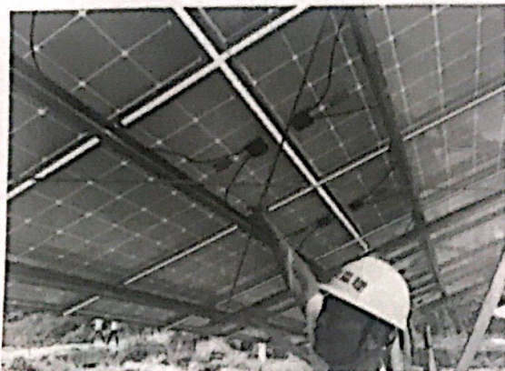
4、背拉杆螺栓未紧固。
