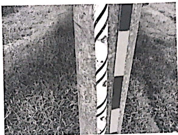
13、PVC 管塑料膜没清理。
