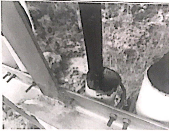
7、防火泥封堵不到位。
