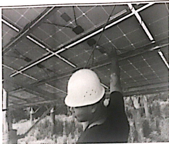
8、背拉杆螺栓不紧固
