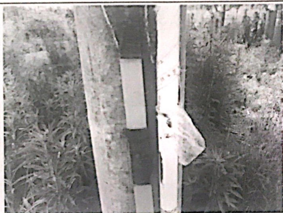
9、PVC 管塑料未清理。
