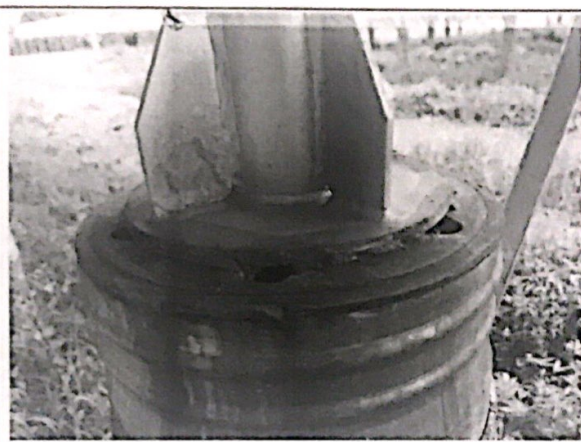
9、桩头防腐，防锈不合格。
