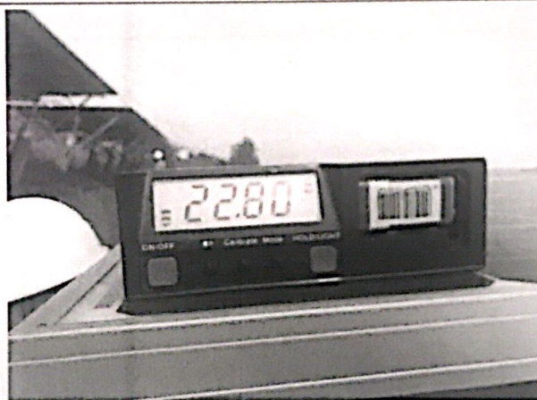
4、组件角度不合格，角度应为 19—21 度之间，部分组件均有此类现象。
