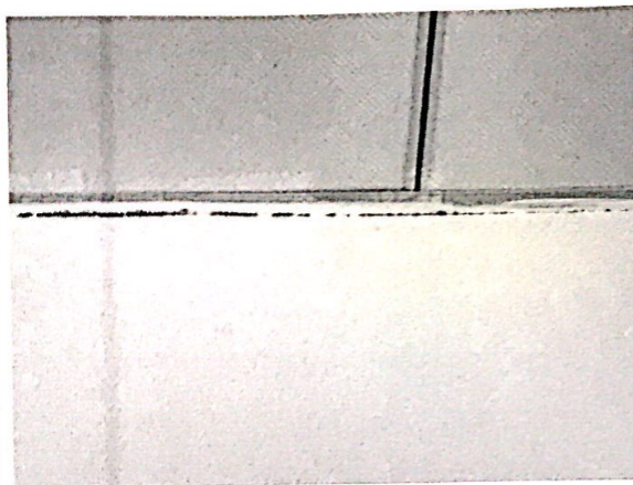
8、吊顶边压条有生锈迹象。
