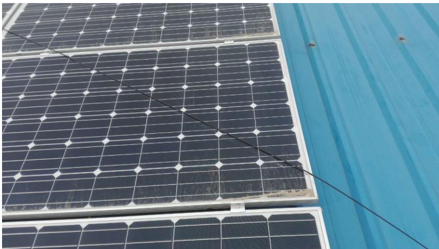
10、屋面个别组件接地线搭接错位。
