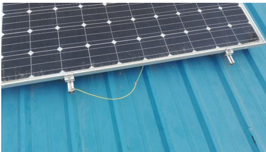
11、屋面组件上有异物、尘土等，立即清理。
