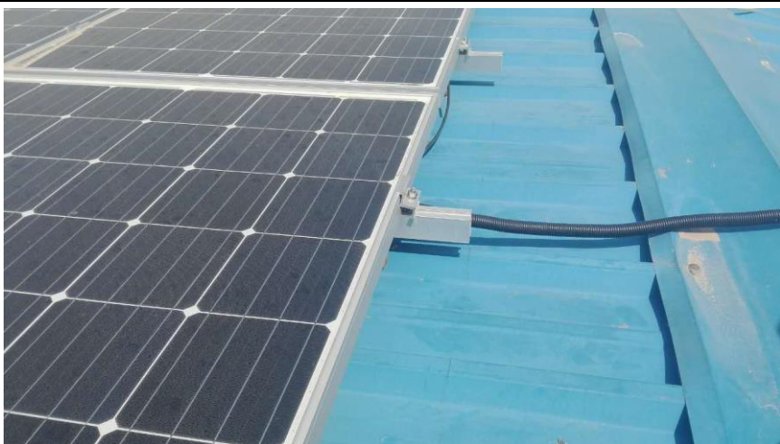
17、屋面部分电缆保护软管保护不到位。
