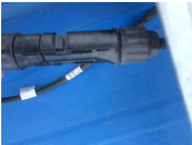
19、地面电缆桥架拐弯处未采取保护措施。
