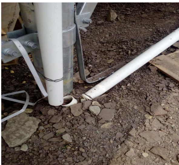
18、地面部分 MC4 接头紧固不到位。
