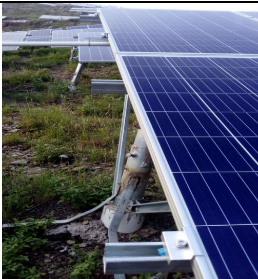
17、地面部分电缆保护不到位。
