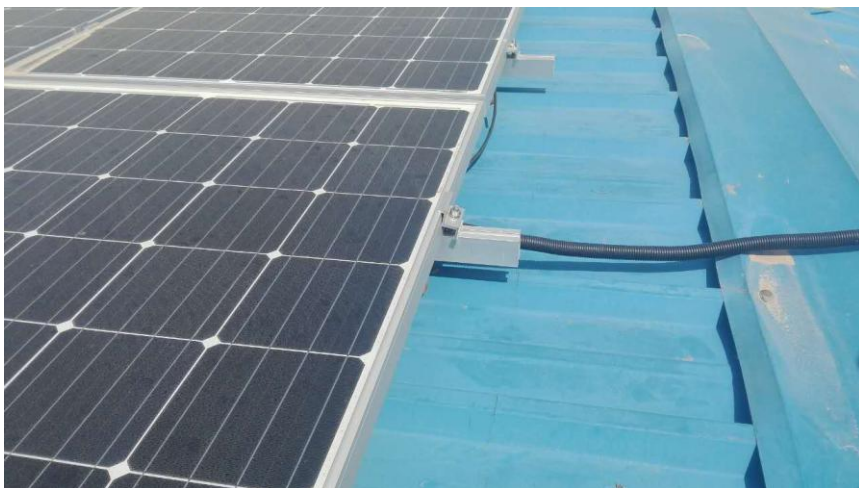
5、屋面部分电缆保护软管保护不到位。
