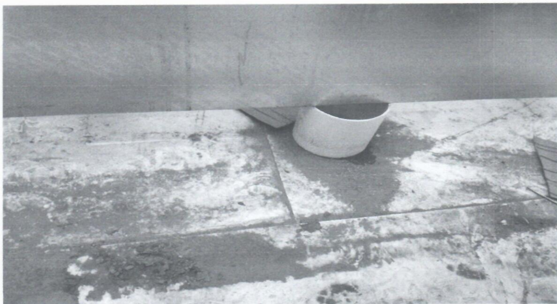
3、电缆桥架底部未粘贴 PVC 卷材
