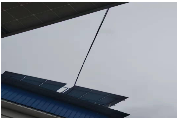
外露光伏线未防护
