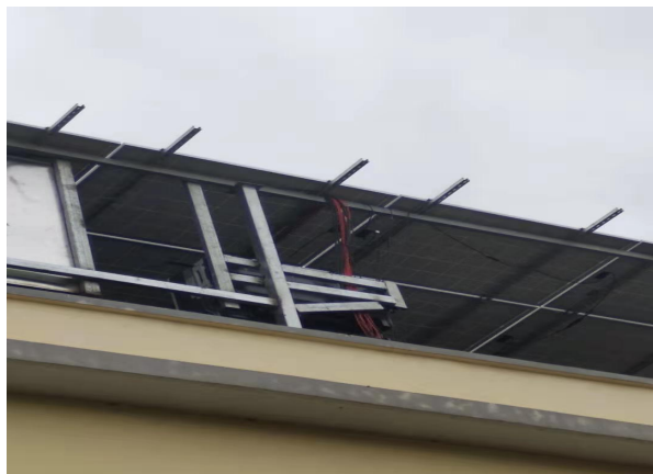
外露光伏线未防护
