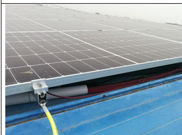
接线管未固定未封堵
