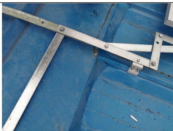
接地扁铁连接处未增加斜扁铁连接
