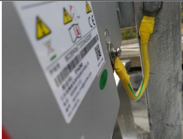
逆变器支架接地未拧紧
