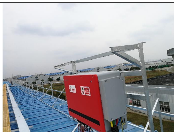
逆变器支架防雨罩未安装
