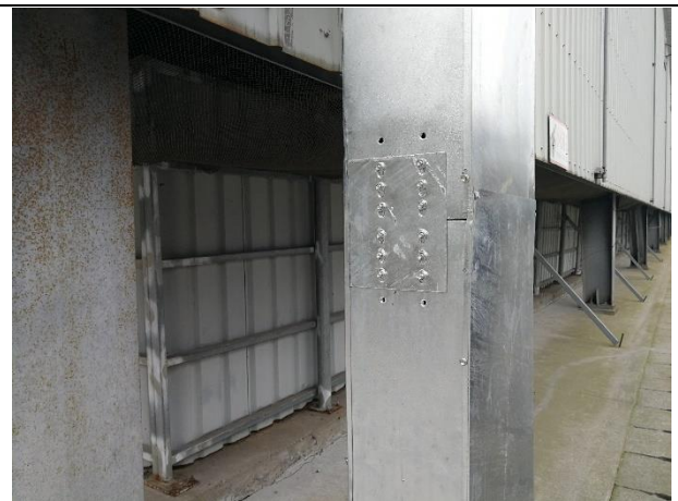
附墙桥架连接处无跨接线
