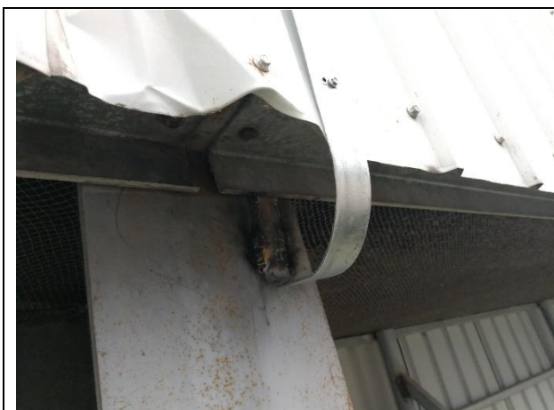
接地焊接焊渣未处理未防腐
