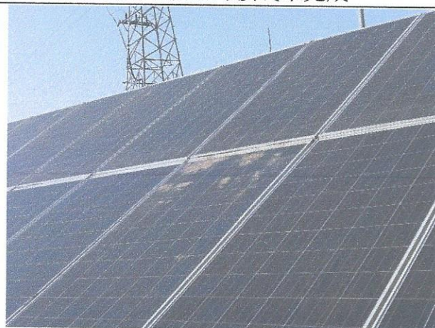
部分组件板面污染较重
