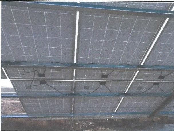
组件间跨接线未完成
