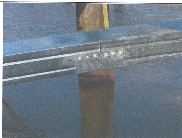
桥架连接处跨接线未完成
