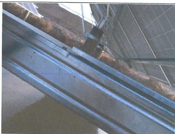
部分地方桥架盖板安装不规范
