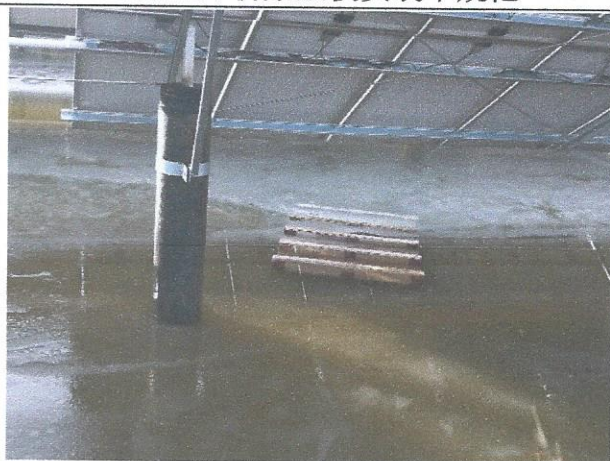
组件托板等垃圾未清理干净
