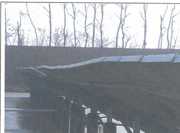
1#区及其他区部分组件高差较大
