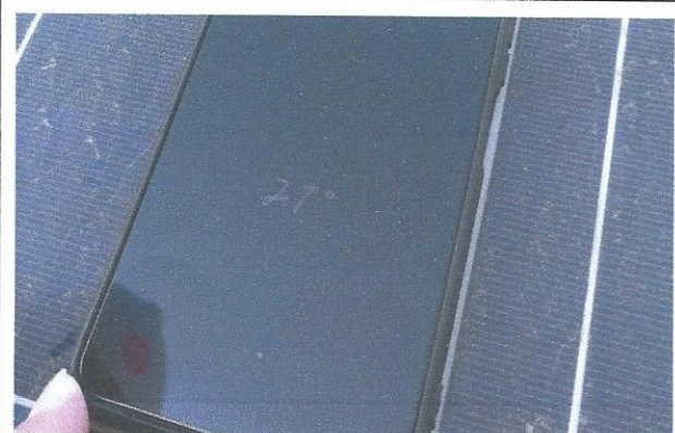
站内 5 区南第五排东阵列倾角现场实测不符合要求
