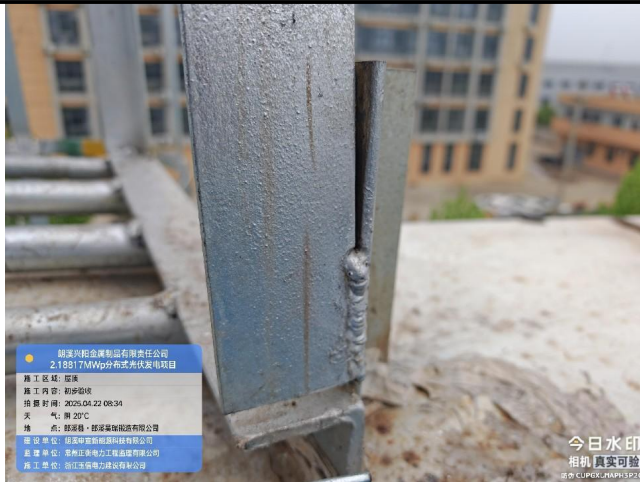
20、爬梯焊接处防腐不到位
