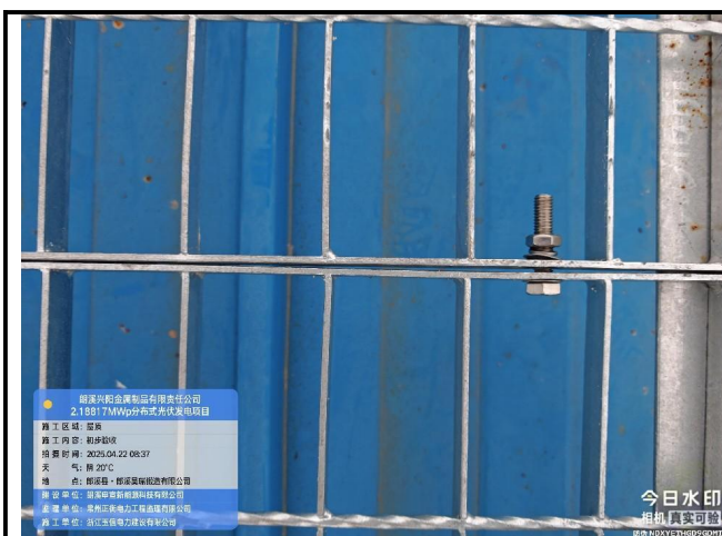
14、现场个别接地扁铁未刷漆
