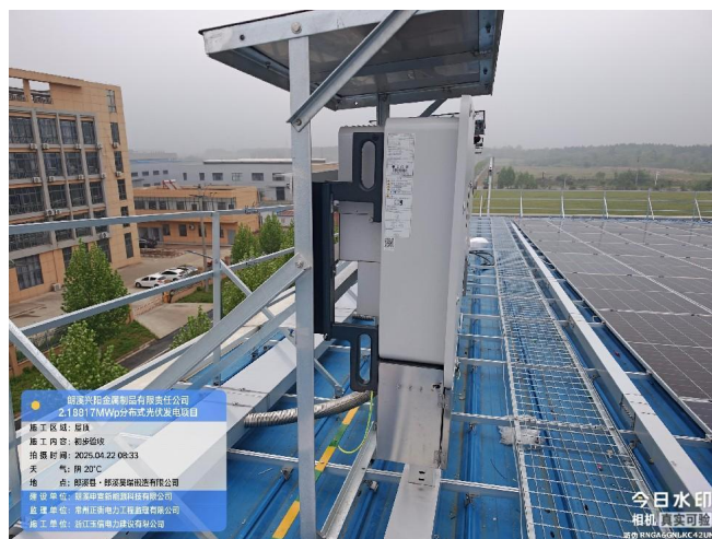
28、个别逆变器雨棚螺栓为安装
