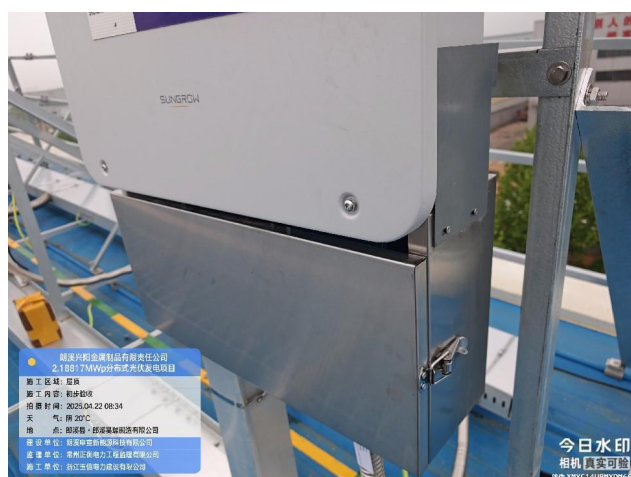
30、个别逆变器软管存在开口
