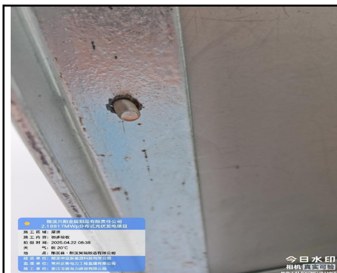
29、个别逆变器下槽盒仍需加固
