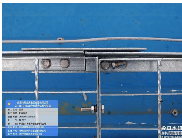
12、运维通道过屋脊处断口未做防腐
