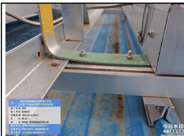
8、1 号逆变器最南边方阵边压块紧固不到位
