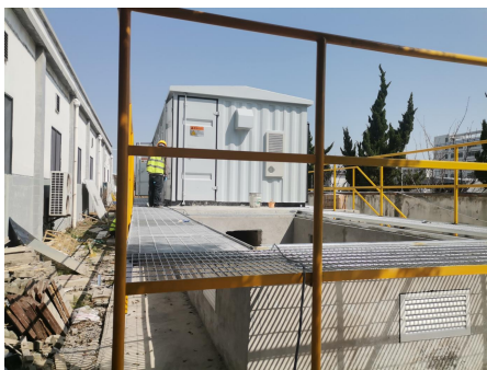
19、预制舱搭火电缆接地扁铁的位置挡住了检修出口
