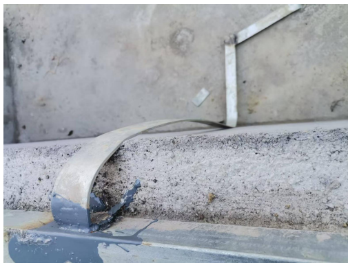
5、预制舱基础存在间隙
