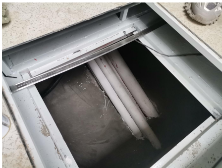
20、预制舱基础下面电缆未固定或绑扎
