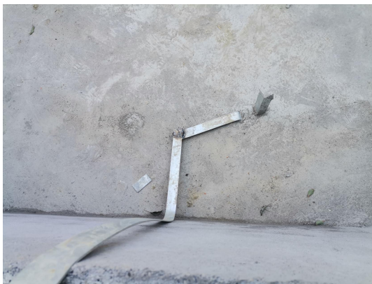
4、SVG、预制舱基础未做接地电阻检测
