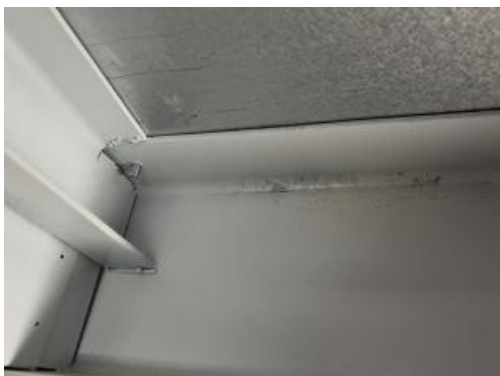
10、设备底座已变形生锈（箱变基础内）
