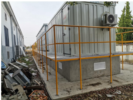
18、检修通道栏杆未做放挡板，有掉落隐患
