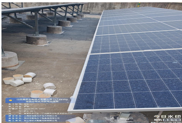
19、个别组件边压未紧固及均未做防松线标识
