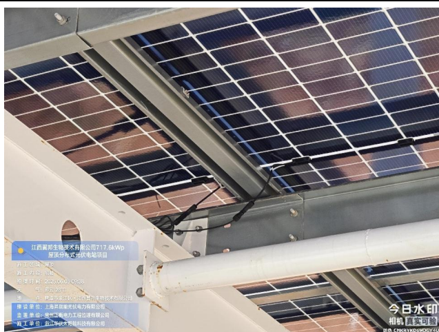
24、车棚逆变器交流侧桥架未做好封堵
