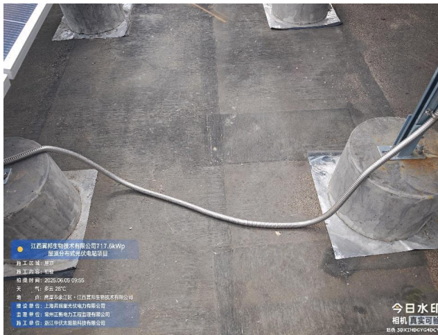
16、水泥墩基础防水涂料粉刷不均匀
