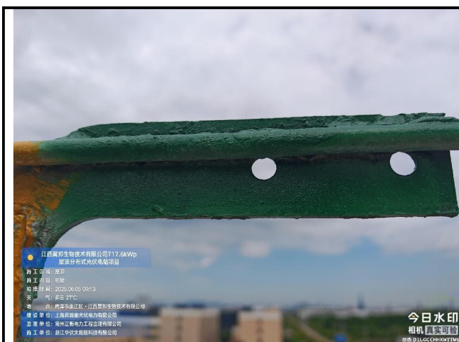
33、支架斜撑存在晃动需要加固
