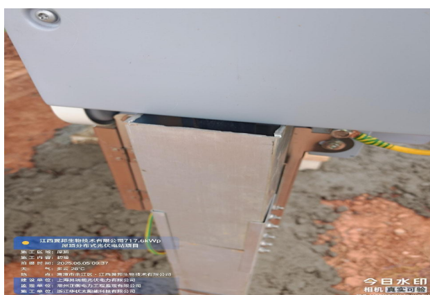
25、车棚逆变器支架焊接后焊渣清理应刷白漆
