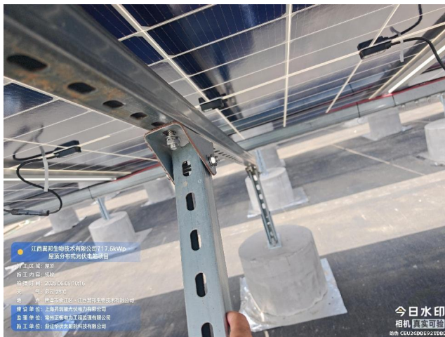
13、现场存在多处刺破垫片未安装
