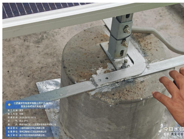
32、接地扁铁下线点未满焊
