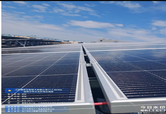
12、支架斜撑未紧固
