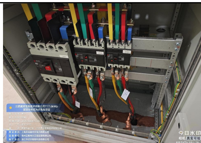
6、接地扁铁与屋面接触容易腐蚀（建议沿女儿墙边缘铺设）
