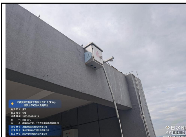
30、个别支架存在倾斜需要调整
