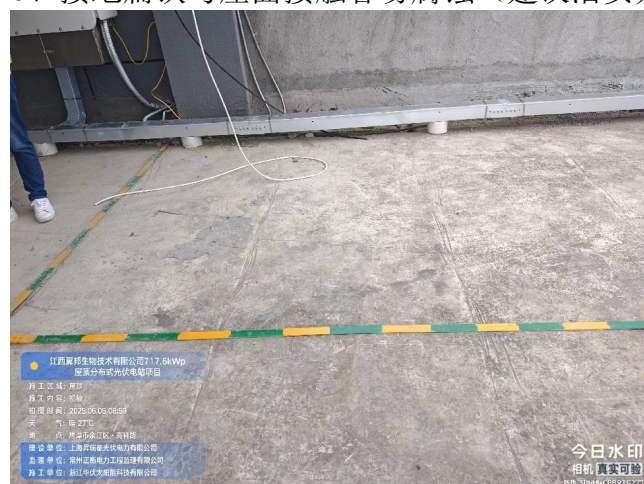
7、逆变器未配备灭火器
