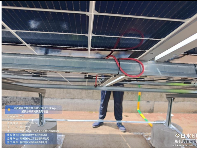
15、直流电缆穿线拖地绑扎松散
