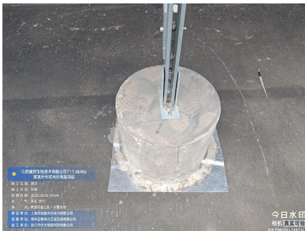
17、多处接地扁铁过路处未折弯
