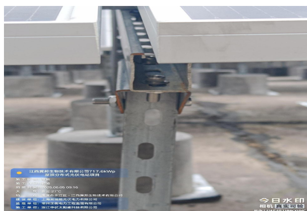
31、接地扁铁焊接后焊渣未清理直接刷漆容易锈蚀
