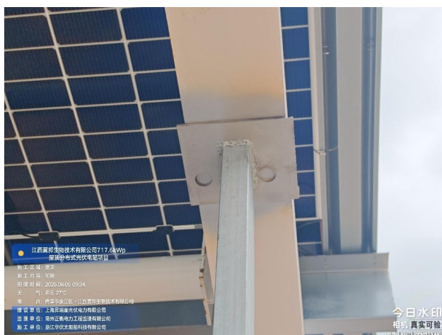
26、车棚逆变器桥架毛刺需要打磨且使用不锈钢扎带固定
