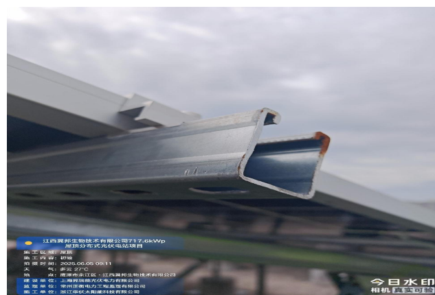
35、支架地脚螺栓应是双螺母现场均是单螺母
