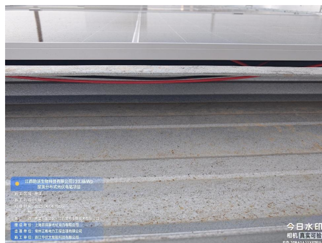
19、直流电缆未穿管
