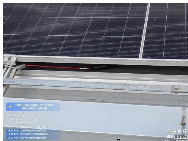
22、现场多处铁锈未及时处理
