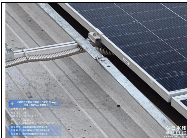
33、逆变器下直流电缆未折弯留有余量
