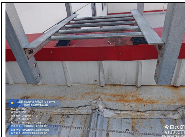
30、桥架不锈钢抱箍未紧固
