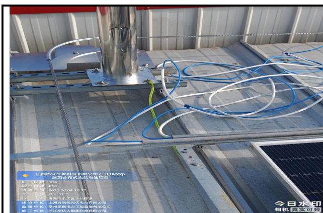
27、直流电缆软管未绑扎
