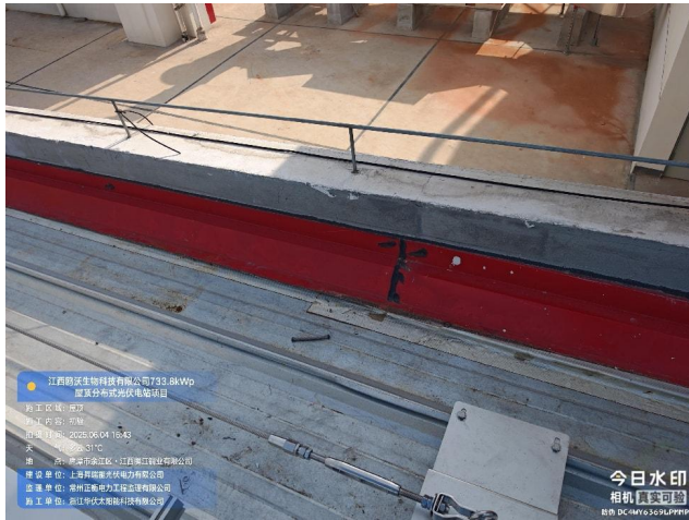
24、视频监控基础需要加固
