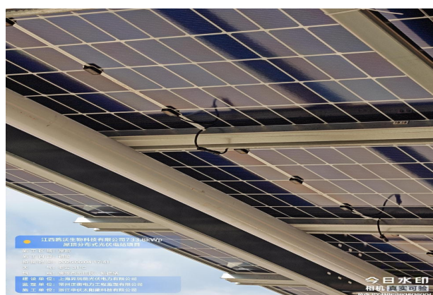
11、组件边压块刺破垫片及组件边框黄绿接地线未安装
