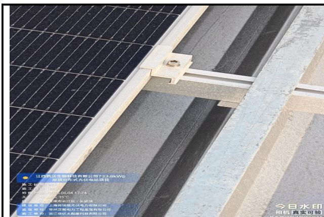
12、组件下直流电缆绑扎松散
