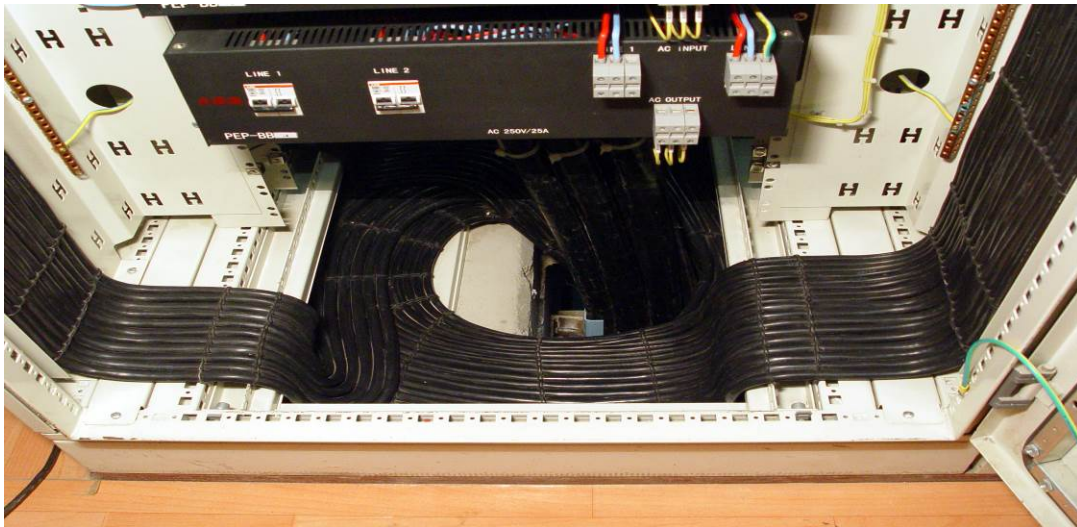
图三计算机柜电缆进线工艺样板图
