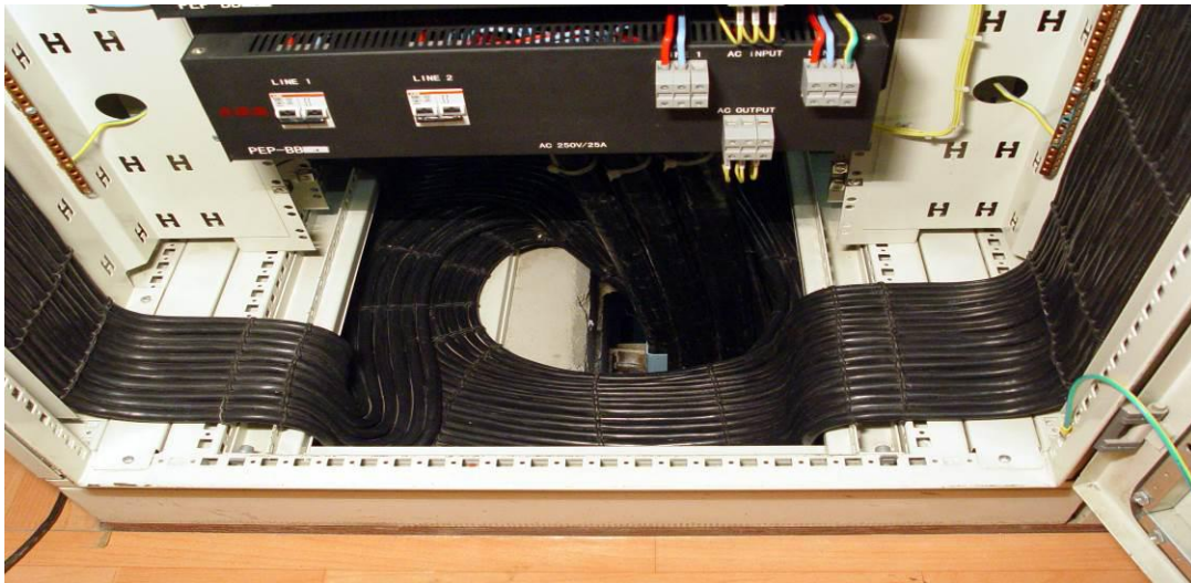
图三计算机柜电缆进线工艺样板图
