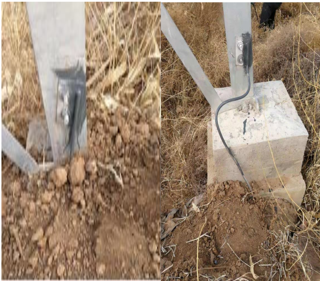
整改后的防雷接地装置
