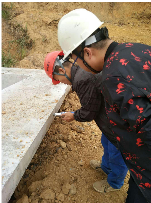
2017 年 10 月 8 日红联光伏区箱变基础强度检查
