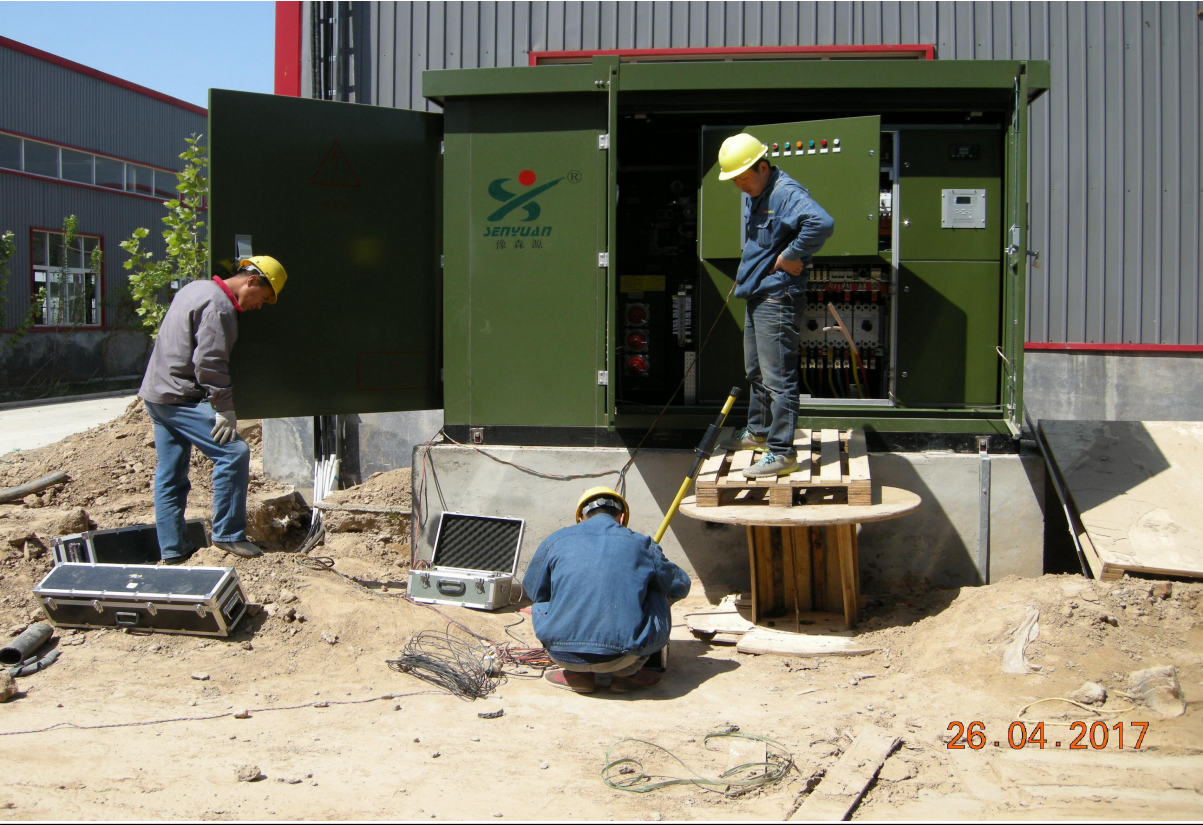
箱变进行检测。
