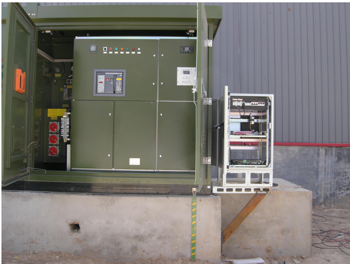
数据采集柜已安装完成 5 台，鑫茂厂区一台正在进行安装过程中。共计：6 台
