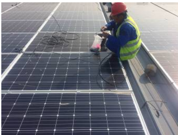
1#、3#屋面电缆的接并线
