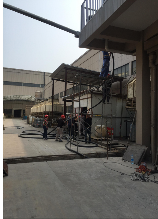
开关站至配电室高压电
