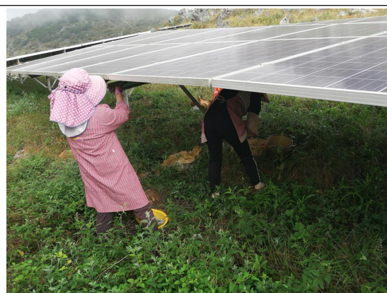
南区 8 号方阵前期安装问题支架整改
