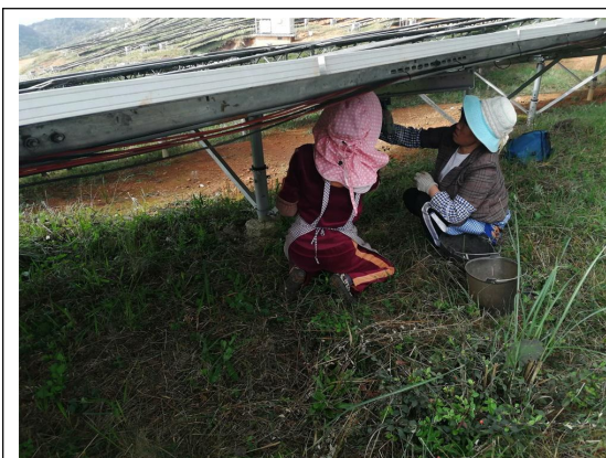
南区 8 号方阵前期安装问题支架整改
