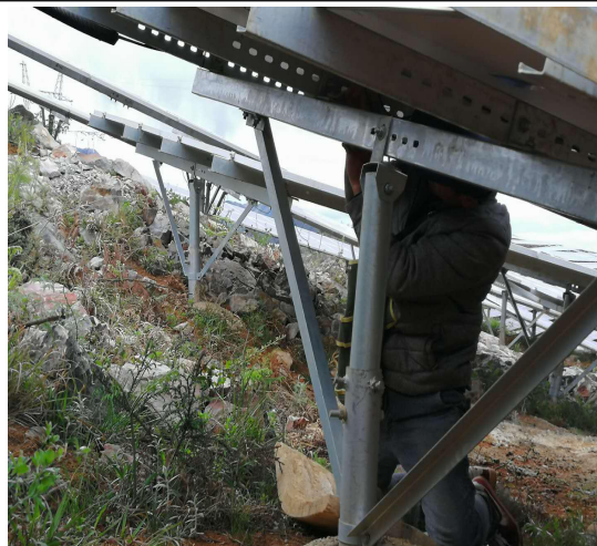
光伏区 9#方阵支架整改
