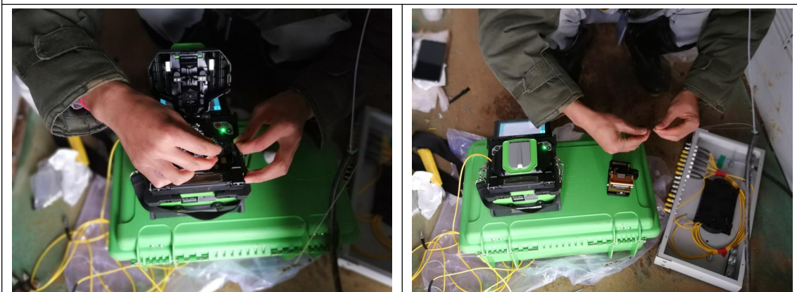
光伏东区 19 号方阵箱逆变设备内通讯光纤熔接
