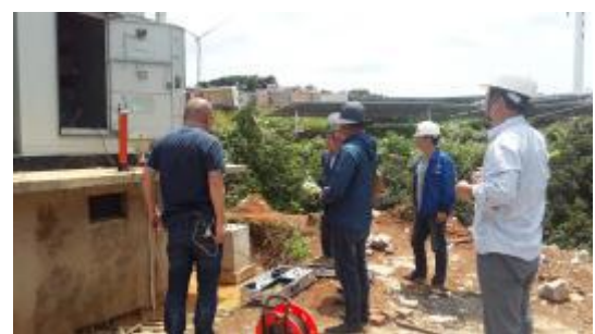
光伏区 5#方阵箱逆变设备检测
