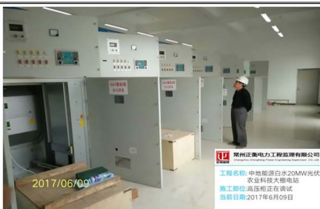
高压柜带电调试
