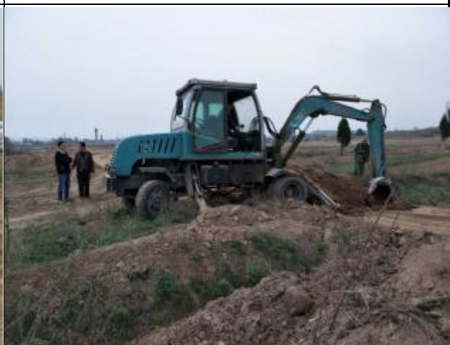
东北区施工便道被挖断
