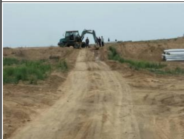
东北区施工便道被挖断
