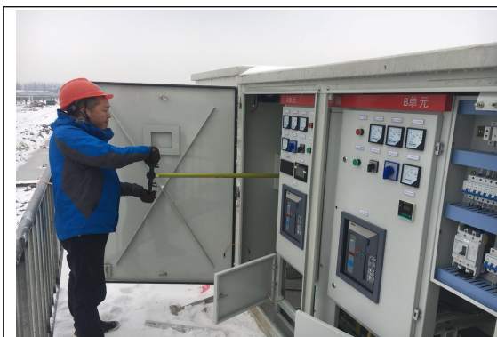
二期 B05 区箱变投运
