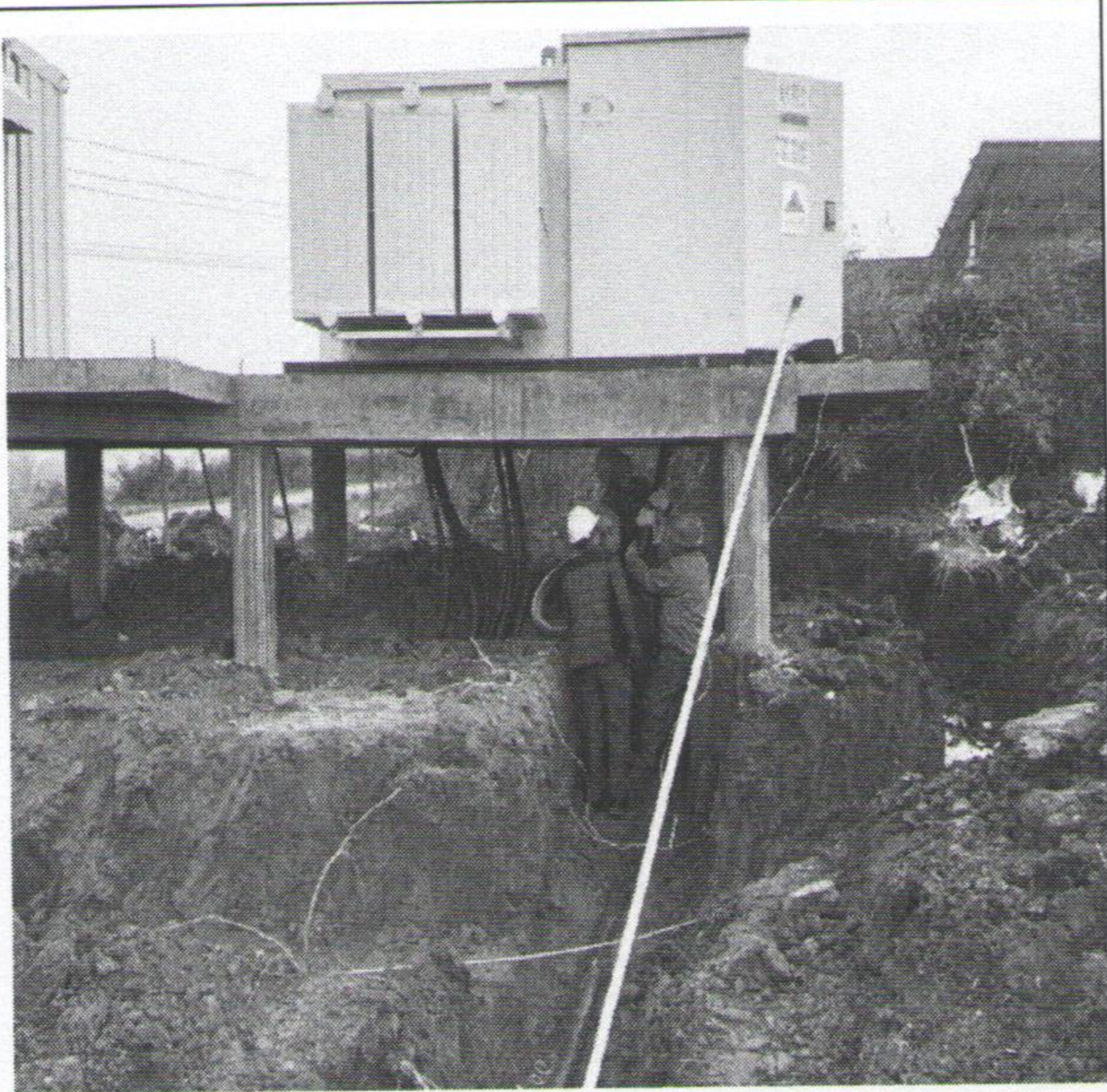
箱变高压电缆接线
