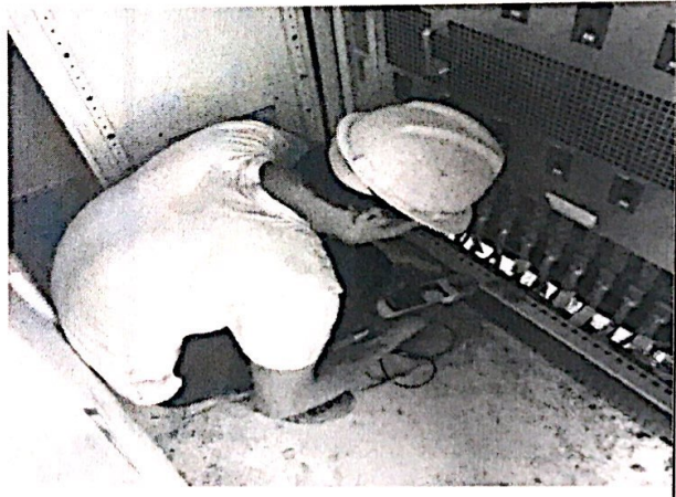
检查汇流箱电流
