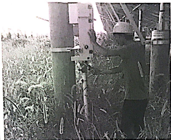
16 区电气消缺整改
